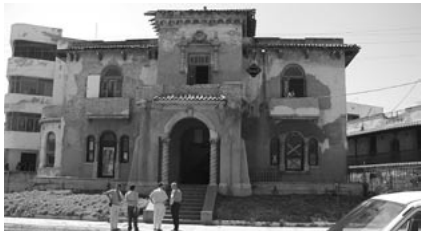
Sonne, Salz und Sprühwasser lassen auf Kuba die Fassaden bröckeln, auch an dem „Calzada“ heißenden Vorlesungsgebäude des nationalen Wissenschaftsrates. Foto: FHG/WB
