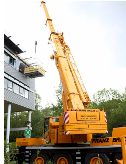
Ende Juni war schweres Gerät an Gebäude A5 am Gelsenkirchener Hochschulstandort Neidenburger Straße 43 im Einsatz: Per Kran schwebte der neue Magnetresonanztomograf in den Übungsoperationssaal der Medizintechnik. Foto: WH/BL
