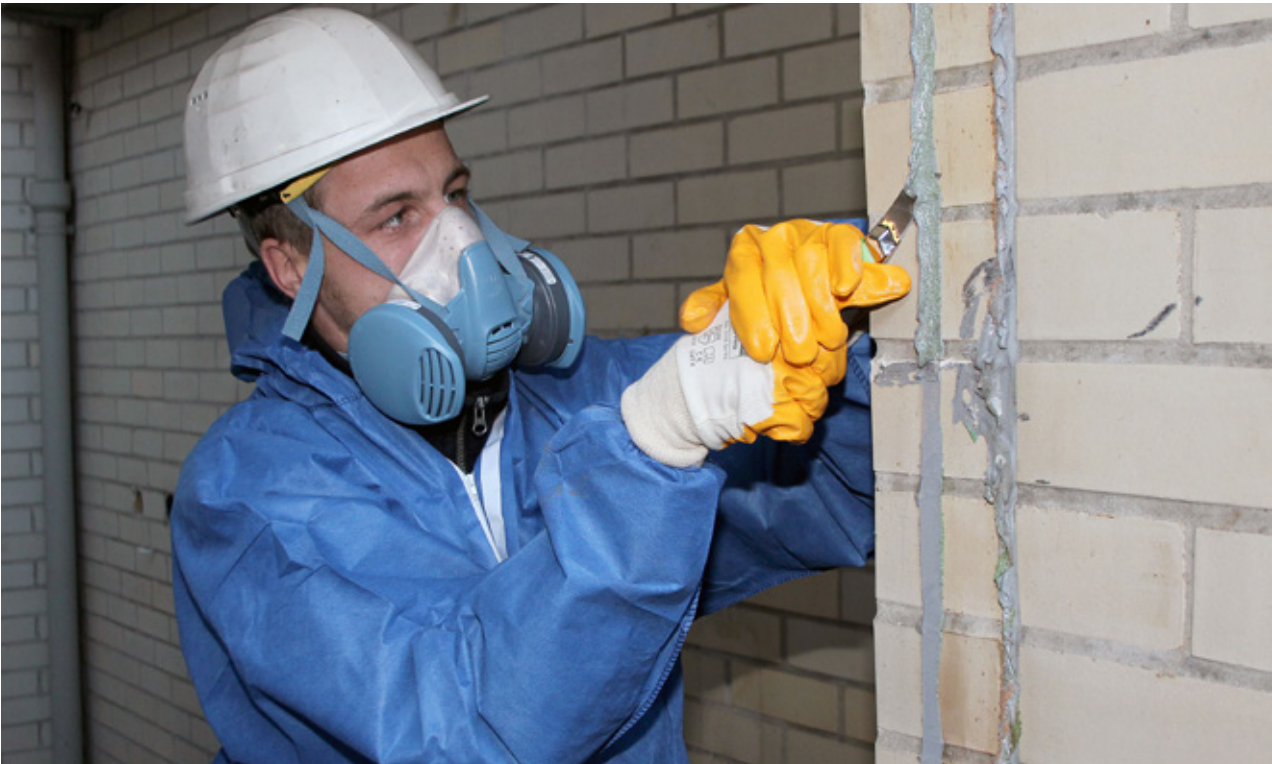
In diesem Schutzanzug verbirgt sich Fabian Weise von der Abbruchfirma Linkamp. Gerade entfernt er PCB-haltige Dichtungen in einer Türfuge. Foto: WH/BL
