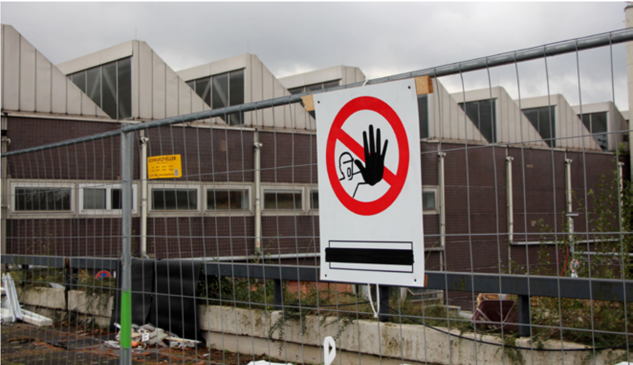
Seit Mitte Oktober werden die PCB-belasteten Altgebäude an der Neidenburger Straße 10 abgerissen. Schilder warnen vor dem Betreten der Baustelle. Foto: WH/BL
