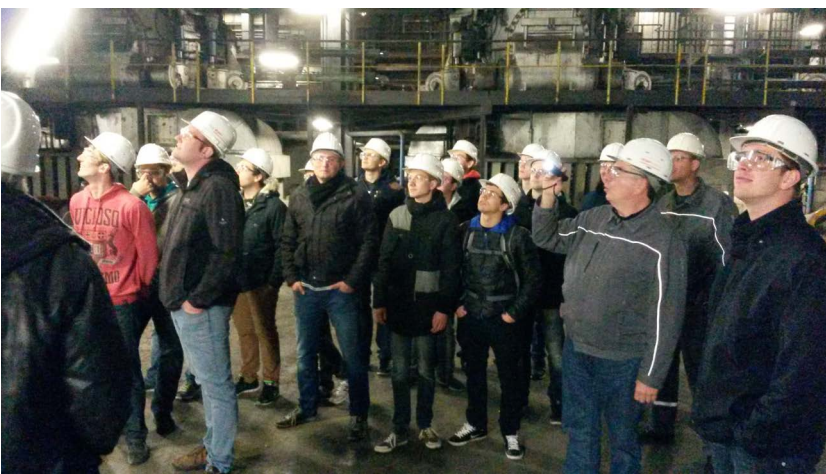
Im Kesselhaus: Wegen seiner Ausdehnung bei Betriebstemperatur steht der Kessel nicht, sondern er hängt an der Decke. Im Hintergrund: Die Kohlemühlen, die die Steinkohle in feinen Staub zermahlen, damit sie passend zur Gewinnung von Prozessdampf und Strom schnell und sauber verbrannt. An den grauen Jacken mit Leuchtstreifen sind die Eon-Mitarbeiter Jörg Schlottmann (vorne) und Sebastian Kemper (hinten) zu erkennen. Foto: WH/Markus Rüter
