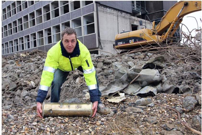
Fabian Weise vom Abrissunternehmen Linkamp barg die Gründungshülse vom Gebäude Neidenburger Straße 10 in Gelsenkirchen-Buer. Foto: WH/BL
